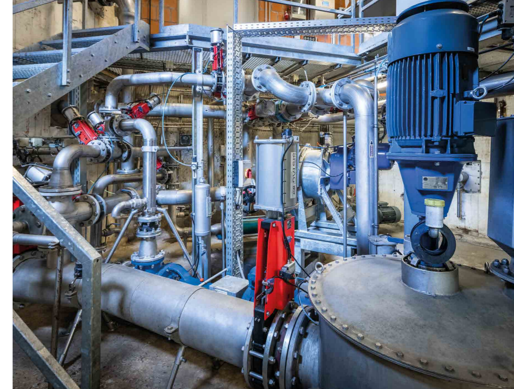
Pumpen und Verteileranlage mit intelligenter Substrataufbereitung
