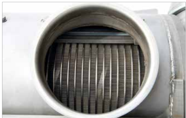
Revisionsöffnungen in Einlauf- und Siebgehäuse
