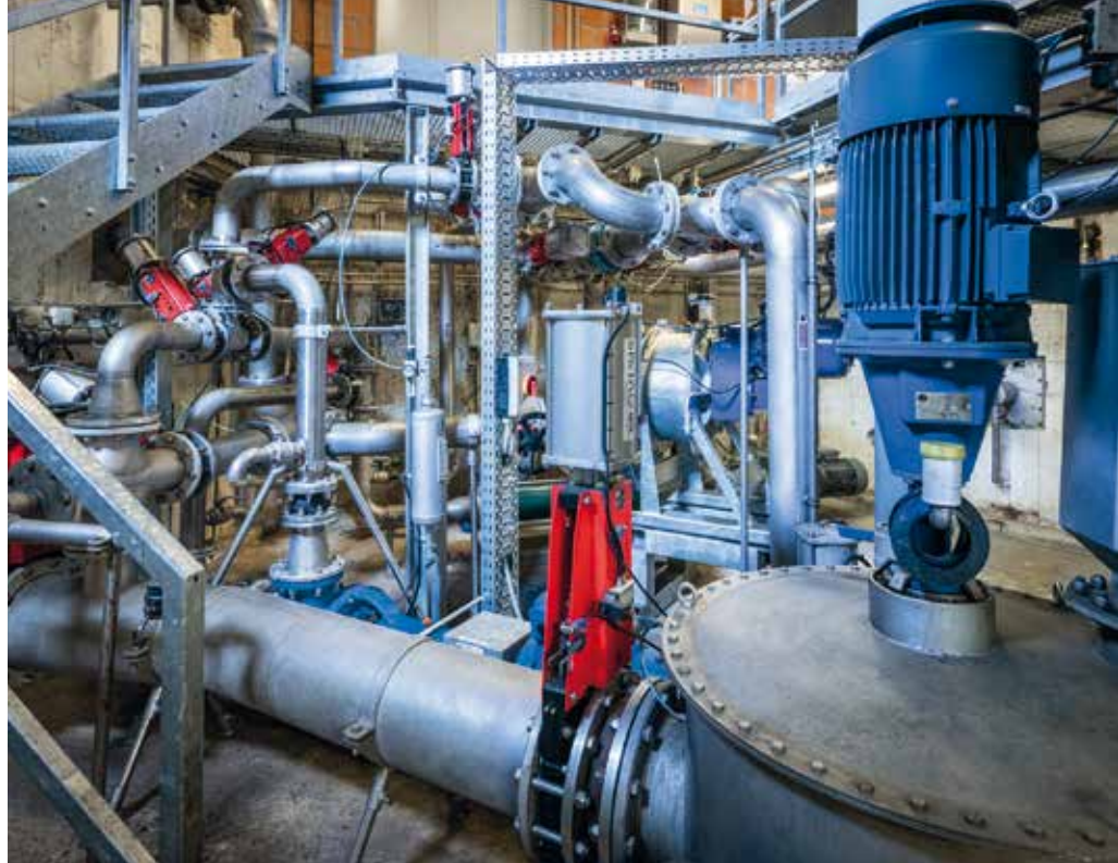
Pumpen und Verteileranlage mit intelligenter Substrataufbereitung
