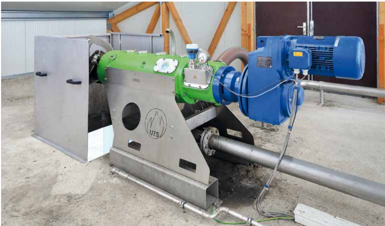
Separationsstufe vor einer Vakuumverdampfungsanlage
